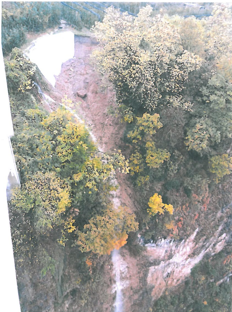
Foto 5. km 37+400 ca. in loc. Santa Giustina: frana in prossimità della spalla in destra orografica del ponte ad arco "Santa Giustina" sul torrente Noce
