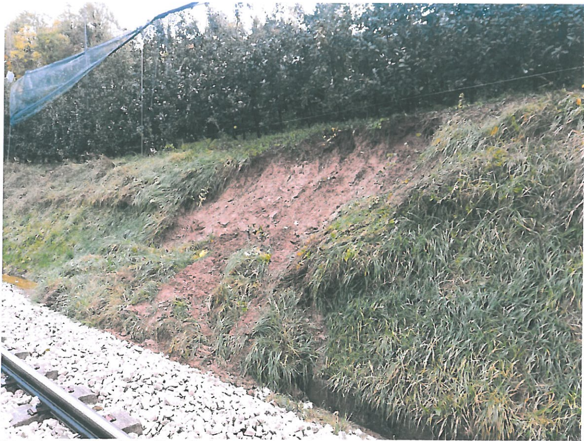
Foto 4. km 35+900 ca. in loc. Dermulo: fenomeno di scivolamento della coltre superficiale del pendio a monte della linea
