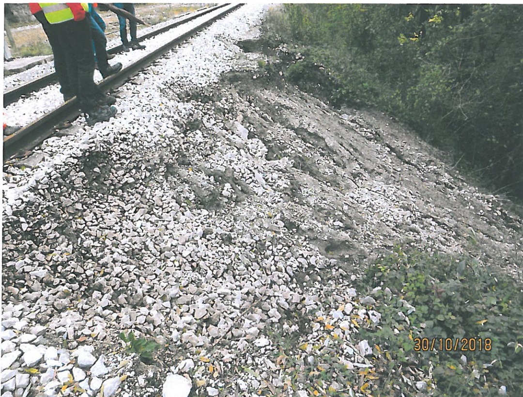
Foto 2. km 23+500 ca. in loc. Masi di Vigo: scivolamento della coltre superficiale a valle della sede ferroviaria
