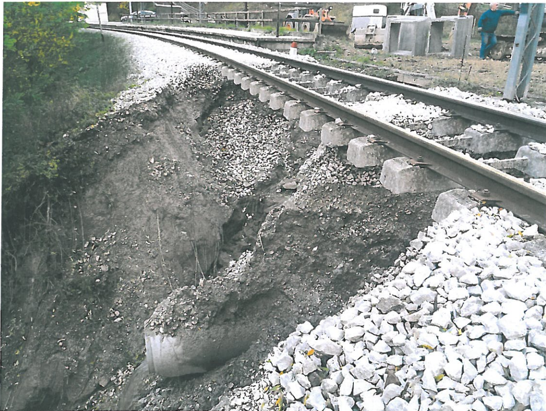
Foto 1. km 23+500 ca. in loc. Masi di Vigo: smottamento dell'intero corpo ferroviario
