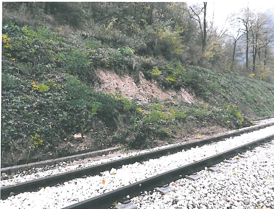
Foto 3. km 23+800 ca. in loc. Masi di Vigo: scivolamento della coltre superficiale del pendio ubicato in fregio alla linea con accumulo del materiale mobilizzato sulla sottostante sede ferroviaria
