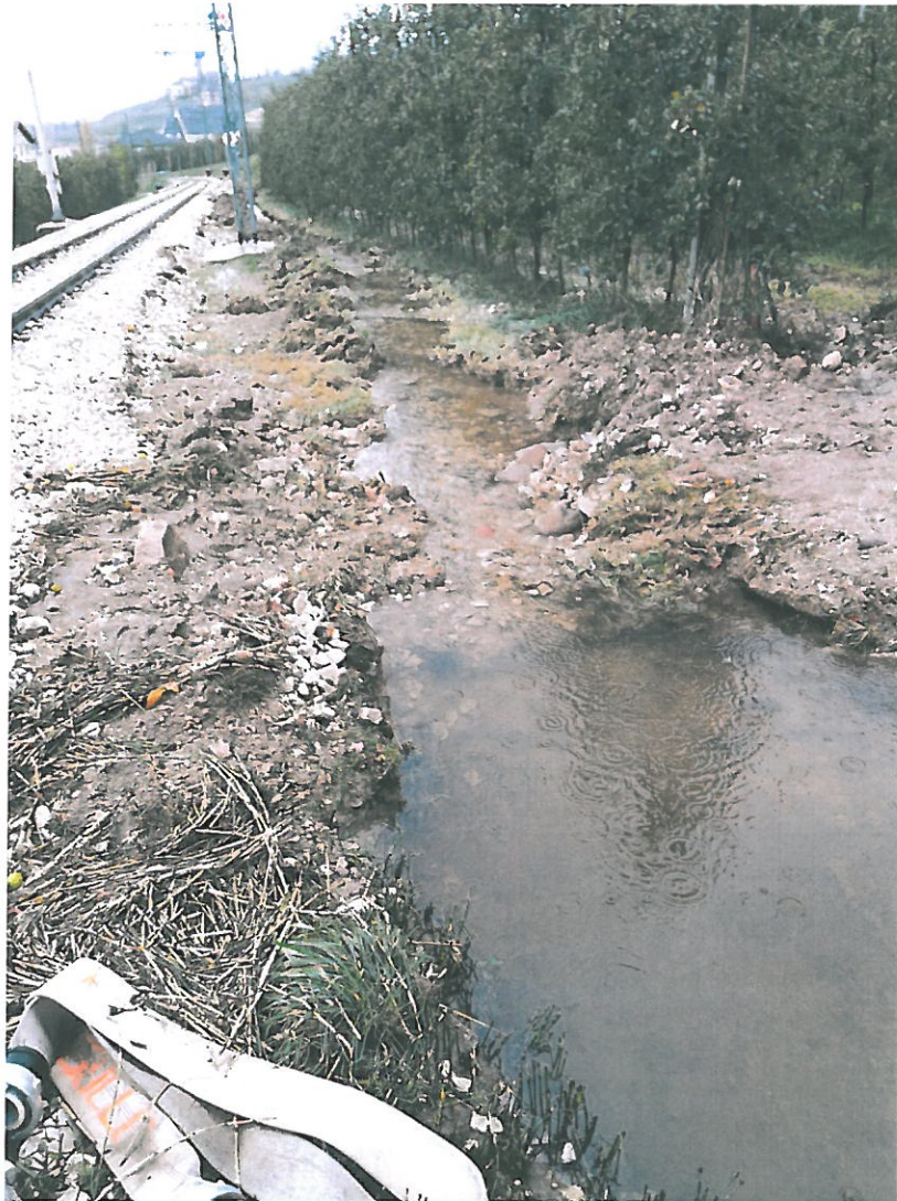
Foto 6. km 38+500 ca. in loc. Tassullo: allagamento della sede ferroviaria
